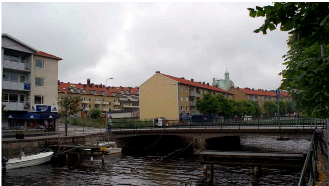
Ill. 11. Strömsån och rivningstomten efter Hedelinska huset på kv. Skepparen 8, mot NO.
