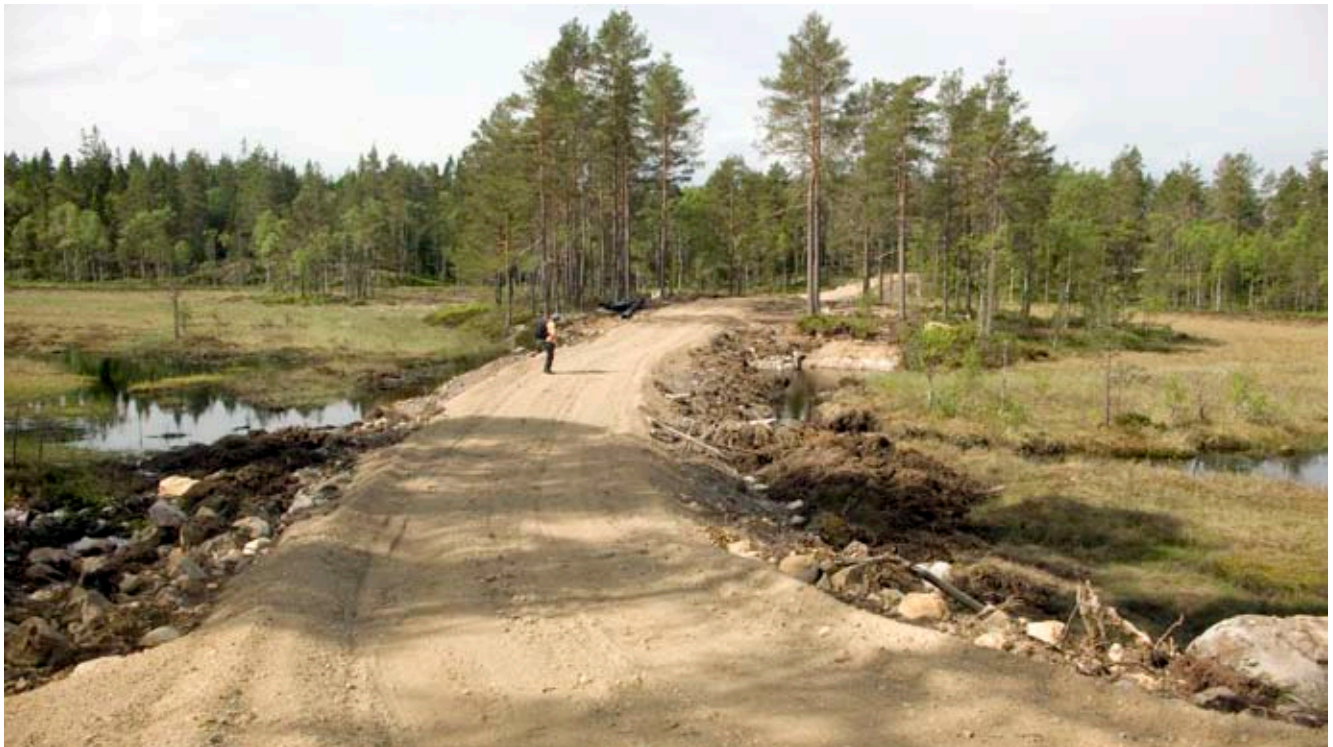
Ill. 5. Skogsbilväg under anläggande, foto från 2008, söder om Stensvattnet. Vägen kommer att användas inom projektet och kommer att behöva förstärkas men inte breddas, enligt projektören. Foto mot nordost.
