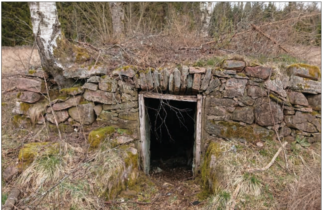
Figur 10. Foto visande den kallmurade ingången till torpets jordkällare. Foto taget mot norr.
