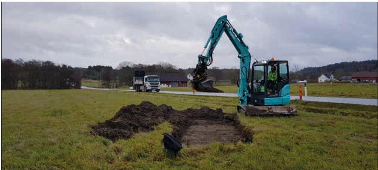
Figur 5. Schakt grävs vid Vävrå mellangård. TMA-fordonet är på plats och sänker farten för trafiken på väg 168. Foto mot sydöst.
