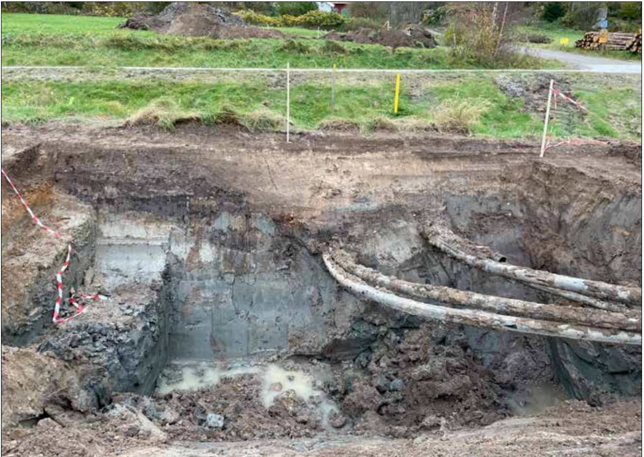
Figur 15. Foto som visar störningarna som fanns väster om väg 745. Ett stort kablage och nedgrävning till detta har skurit igenom ytan vid S106-108. Foto mot öster.
