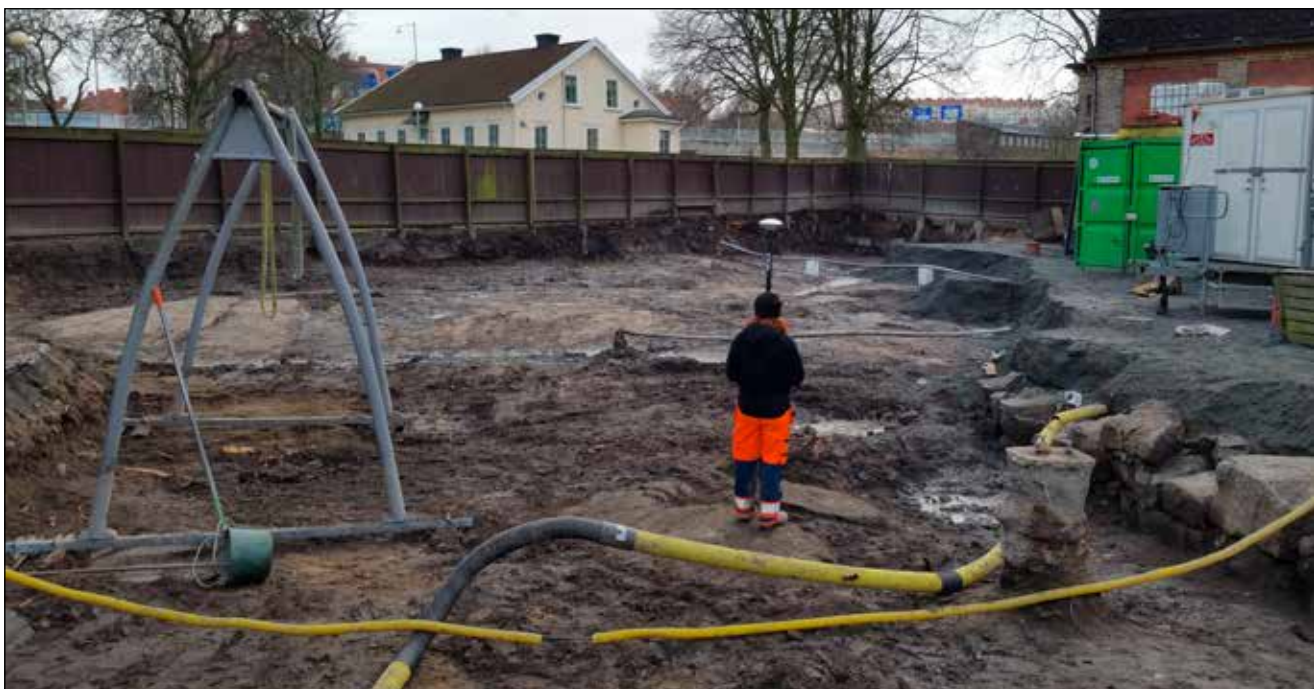
Figur 61. Yta 2 saneringsnivå. Karin dokumenterar den norra delen av stenpackning för dränering. Foto mot syd.
